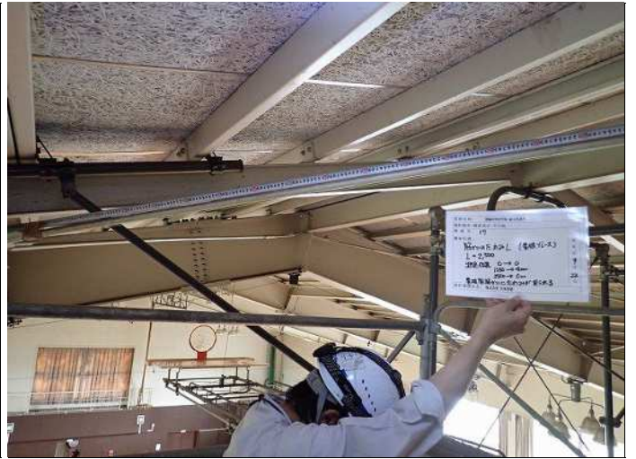
梁間方向 写真番号6詳細 写真番号 7
