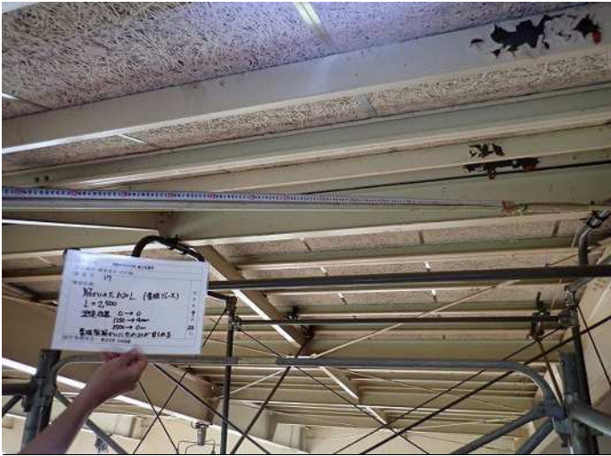
梁間方向 たわみ有 測定長さ=2500mm,変形量=4mm 写真番号 6
