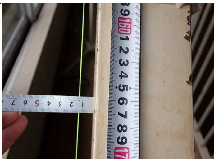
桁行方向 測定用水系設置部中央 水系との距離13mm (変形量 13mm-9mm=4mm) 写真番号 4
