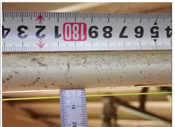
梁間方向 写真番号10詳細 写真番号 11
