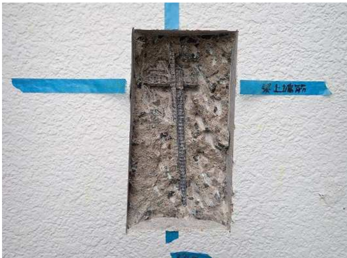
梁1 写真番号24詳細 写真番号 25
