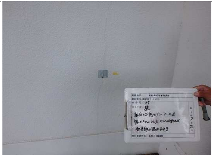
壁 躯体の状態D 幅0.3mm以上のひび割れが部分的に認められる(グレード0.8) 写真番号 4
