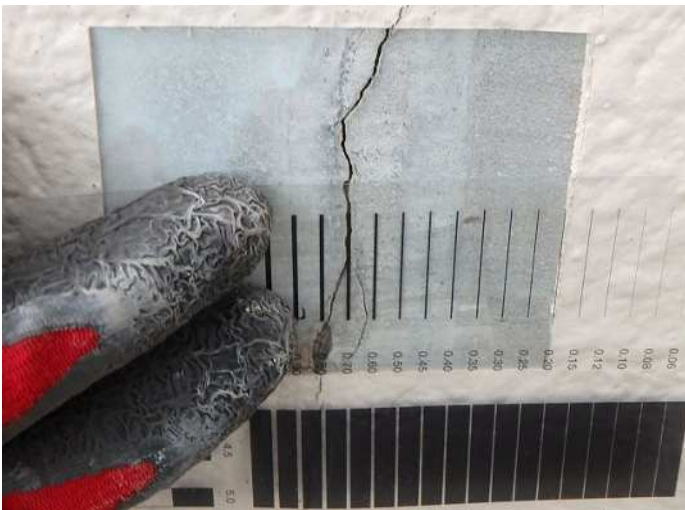
壁 躯体の状態D 写真番号4詳細 写真番号 5
