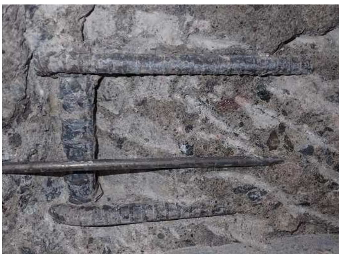
柱脚・柱2 鉄筋腐食度F 写真番号15詳細 写真番号 16
