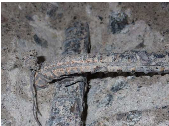
柱頭・柱1 鉄筋腐食度F 写真番号4詳細 写真番号 5
