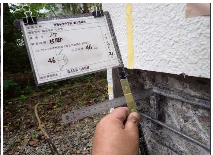
柱脚・柱2 鉄筋かぶり厚さb かぶり厚:4.6cm 写真番号 17
