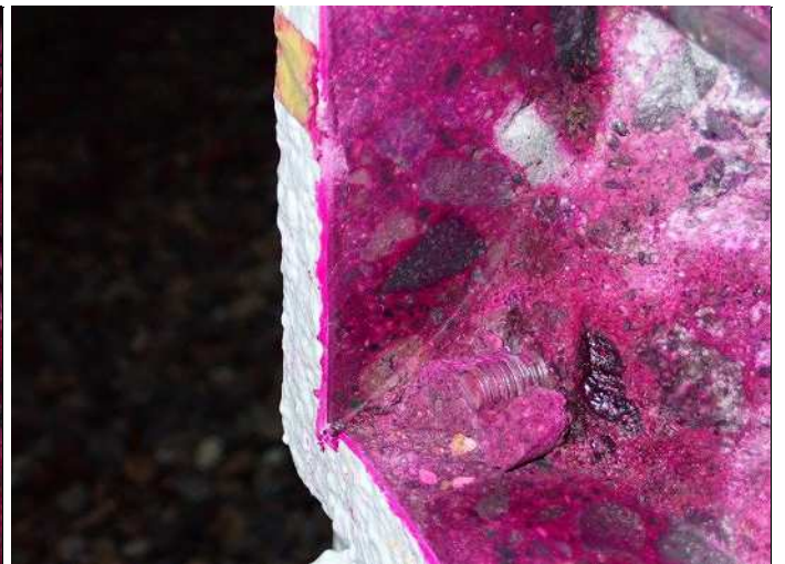
柱脚・柱2 コンクリート中性化深さa 写真番号19詳細(2) 写真番号 21
