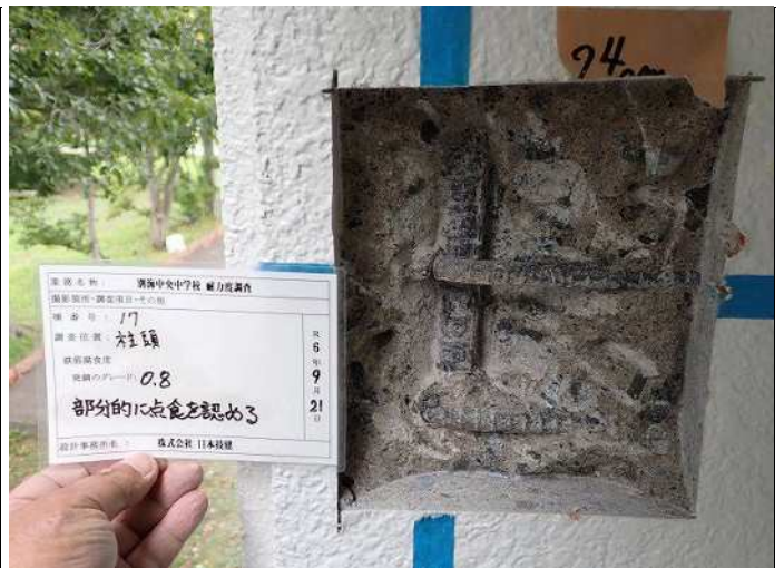
柱頭・柱1 鉄筋腐食度F 部分的に点食を認める(グレード0.8) 写真番号 4
