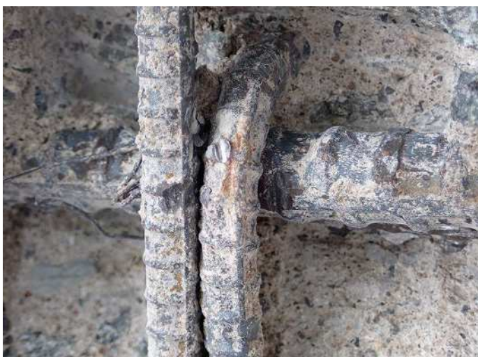
梁2 鉄筋腐食度F 写真番号37詳細 写真番号 38
