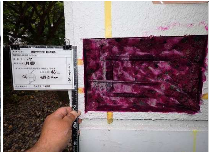
柱脚・柱2 コンクリート中性化深さa 中性化深さ: 0.0cm 写真番号 19
