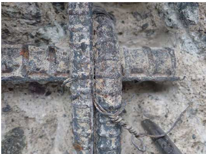
梁1 鉄筋腐食度F 写真番号26詳細 写真番号 27
