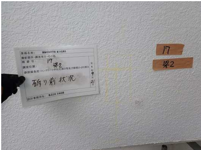
梁2 はつり前状況 写真番号 34
