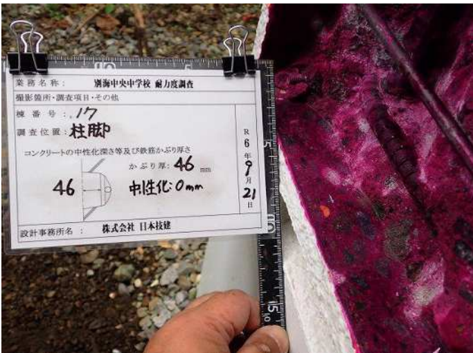
柱脚・柱2 コンクリート中性化深さa 写真番号19詳細(1) 写真番号 20
