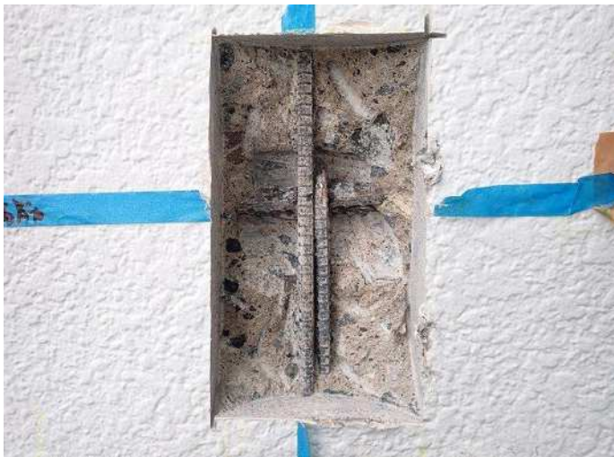
梁2 写真番号35詳細 写真番号 36
