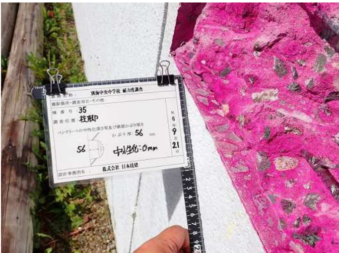
柱脚・柱2 コンクリート中性化深さa 写真番号20詳細(1) 写真番号 21
