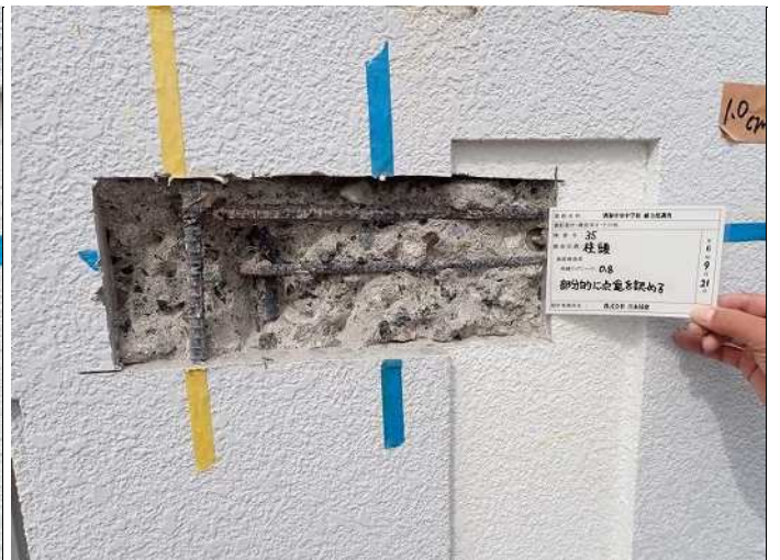
柱頭・柱1 鉄筋腐食度F 部分的に点食を認める(グレード0.8) 写真番号 6
