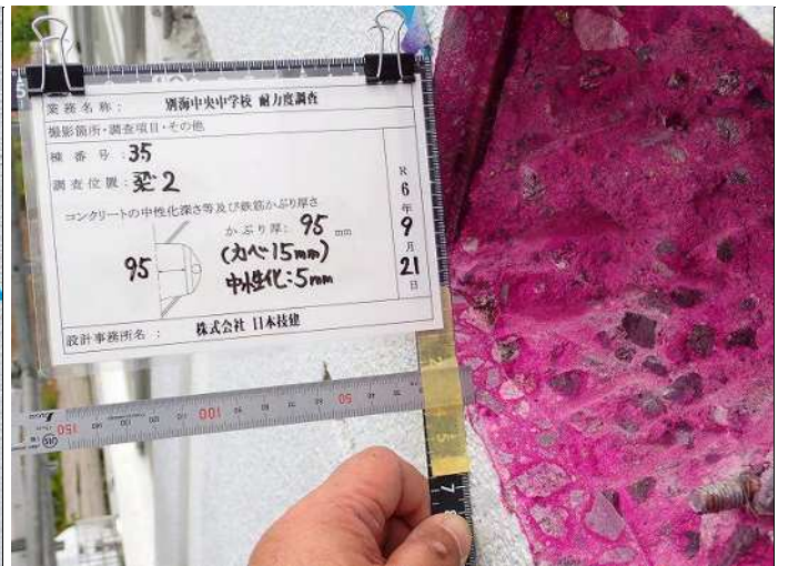
梁2 コンクリート中性化深さa 写真番号44詳細(1) 写真番号 45
