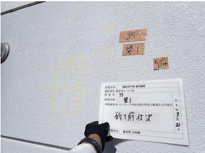
梁1 はつり前状況 写真番号 24
