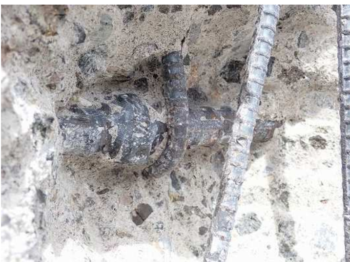
梁1 鉄筋腐食度F 写真番号27詳細 写真番号 28
