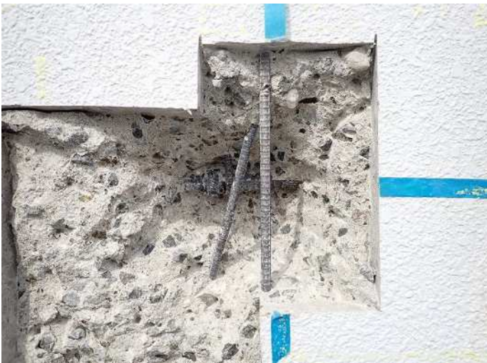
梁1 写真番号25詳細 写真番号 26
