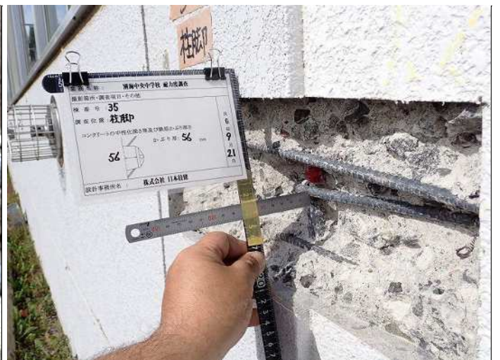
柱脚・柱2 鉄筋かぶり厚さb かぶり厚:5.6cm 写真番号 18
