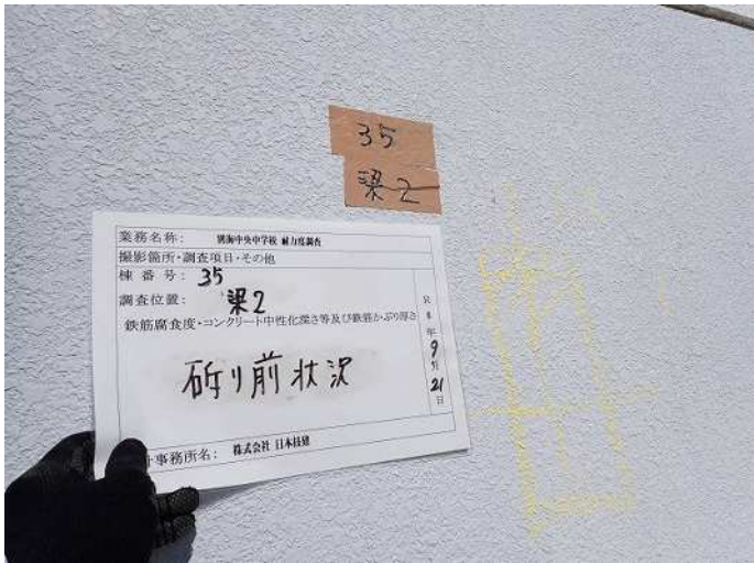
梁2 はつり前状況 写真番号 36
