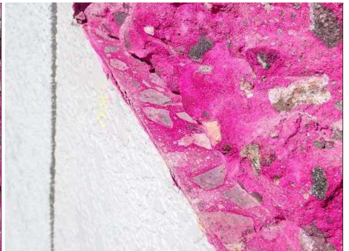
柱脚・柱2 コンクリート中性化深さa 写真番号20詳細(2) 写真番号 22
