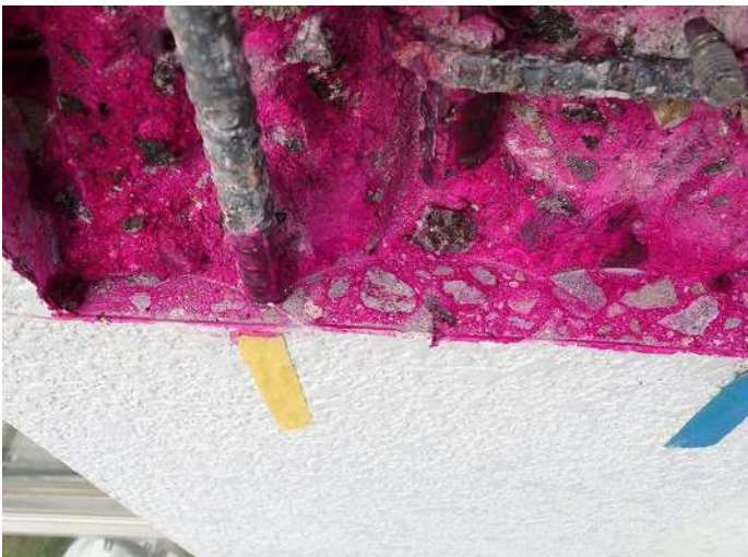
柱頭・柱1 コンクリート中性化深さa 写真番号10詳細 写真番号 11
