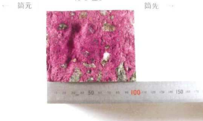
コンクリートの中性化深さ測定(フェノールフタレイン法) 別海中央中学校耐力度調査 別海中央中学校 13-2 壁3
