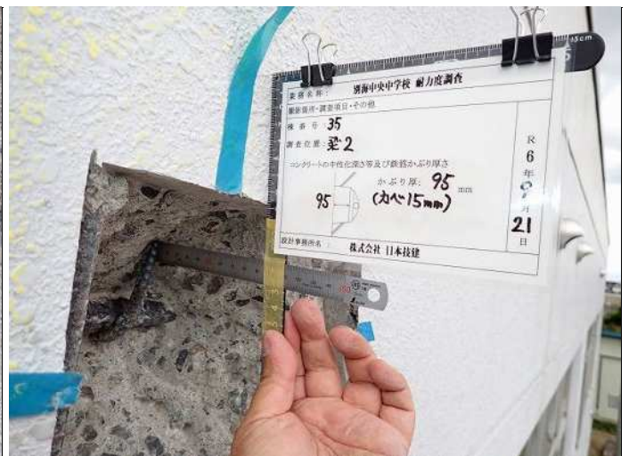
梁2 鉄筋かぶり厚さb かぶり厚:9.5cm(壁縦筋1.5cm) 写真番号 41
