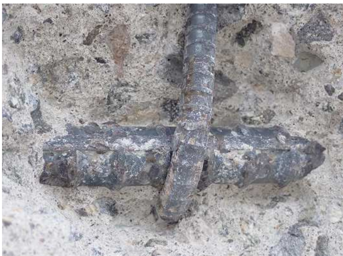
梁2 鉄筋腐食度F 写真番号39詳細 写真番号 40
