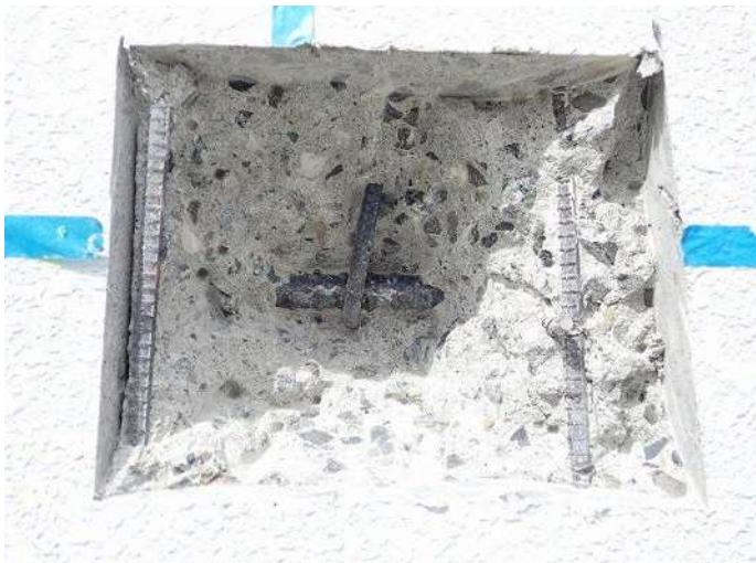
梁2 写真番号37詳細 写真番号 38
