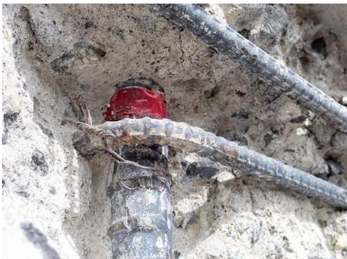
柱脚・柱2 鉄筋腐食度F 写真番号16詳細 写真番号 17
