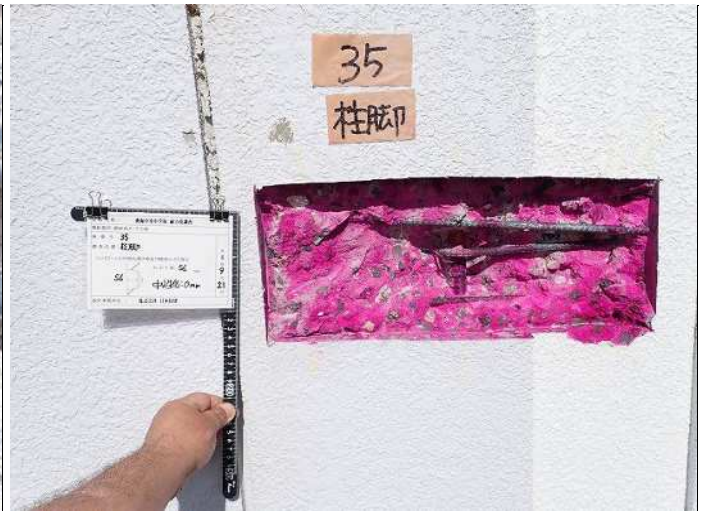
柱脚・柱2 コンクリート中性化深さa 中性化深さ:0.0cm 写真番号 20
