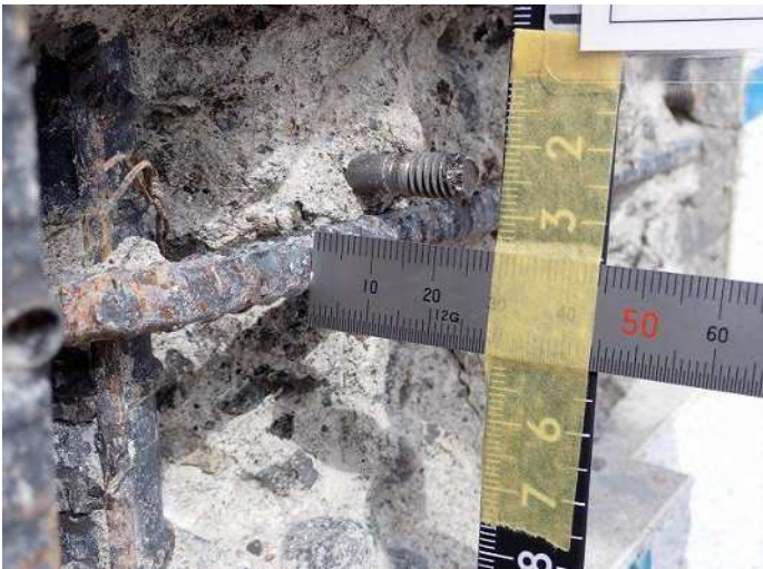
柱頭・柱1 鉄筋かぶり厚さb 写真番号8詳細 写真番号 9
