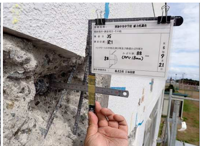
梁1 鉄筋かぶり厚さb かぶり厚:8.8cm(壁縦筋1.8cm) 写真番号 29
