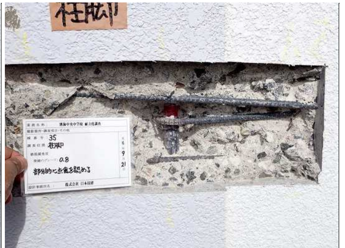
柱脚・柱2 鉄筋腐食度F 部分的に点食を認める(グレード0.8) 写真番号 16
