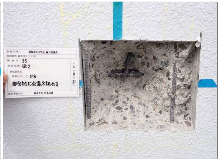
梁2 鉄筋腐食度F 部分的に点食を認める(グレード0.8) 写真番号 39
