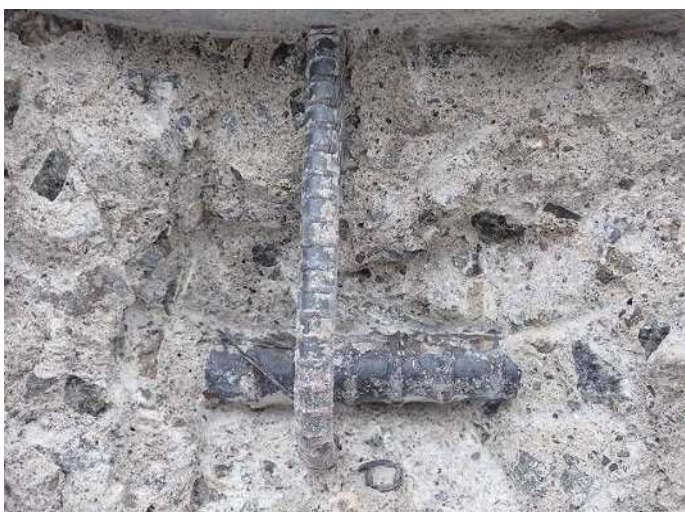
梁2 鉄筋腐食度F 写真番号40詳細 写真番号 41
