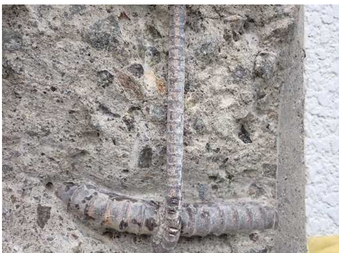
梁1 鉄筋腐食度F 写真番号29詳細 写真番号 30
