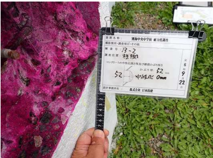
柱脚・柱2 コンクリート中性化深さa 写真番号22詳細(1) 写真番号 23
