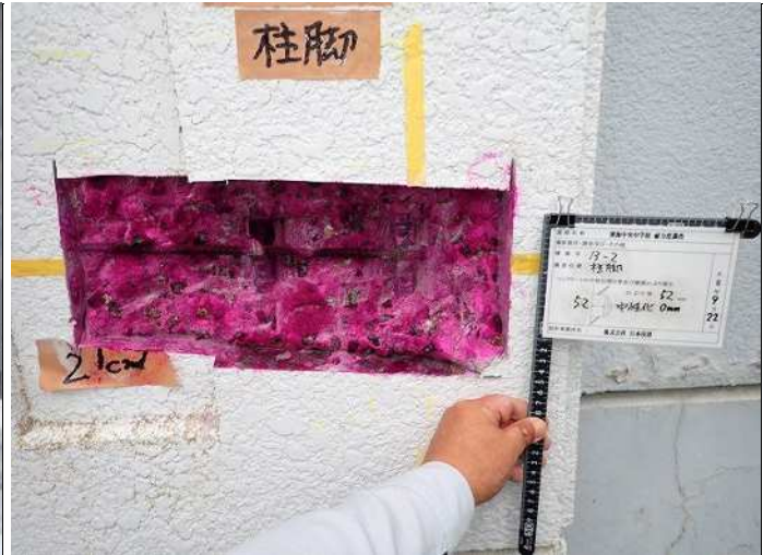
柱脚・柱2 コンクリート中性化深さa 中性化深さ:0.0cm 写真番号 22
