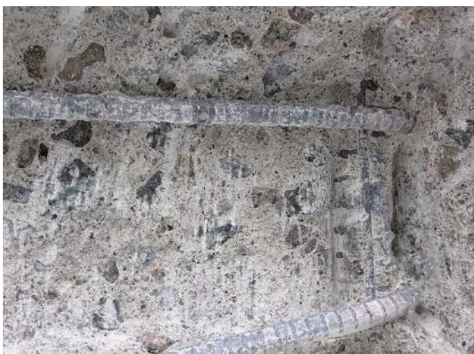
柱頭・柱1 鉄筋腐食度F 写真番号7詳細 写真番号 8
