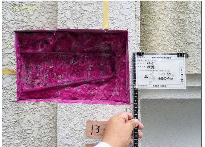
柱頭・柱1 コンクリート中性化深さa 中性化深さ:0.0cm 写真番号 11
