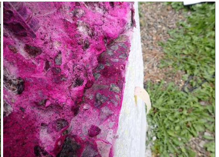
柱脚・柱2 コンクリート中性化深さa 写真番号22詳細(2) 写真番号 24
