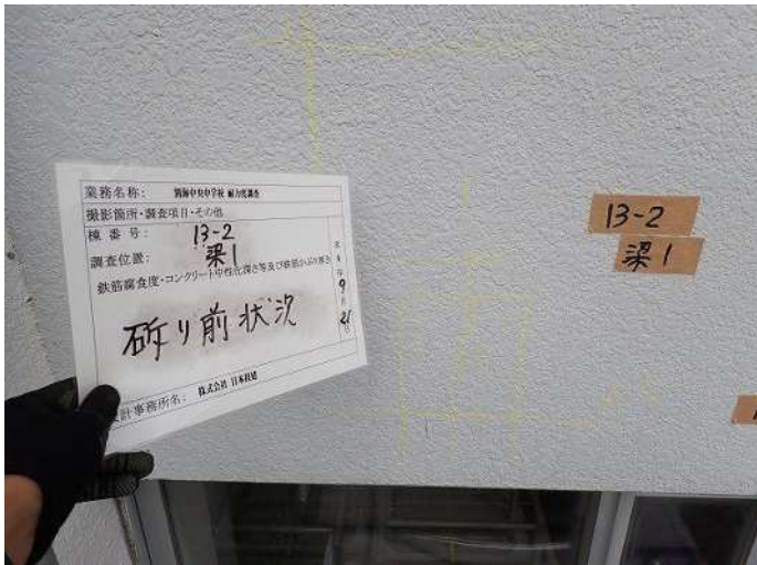
梁1 はつり前状況 写真番号 26
