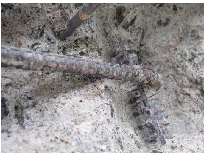
柱脚・柱2 鉄筋腐食度F 写真番号18詳細 写真番号 19
