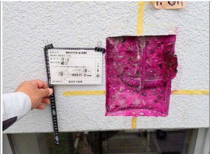
梁1 コンクリート中性化深さa 中性化深さ:0.0cm 写真番号 33
