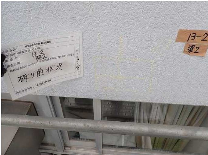
梁2 はつり前状況 写真番号 37
