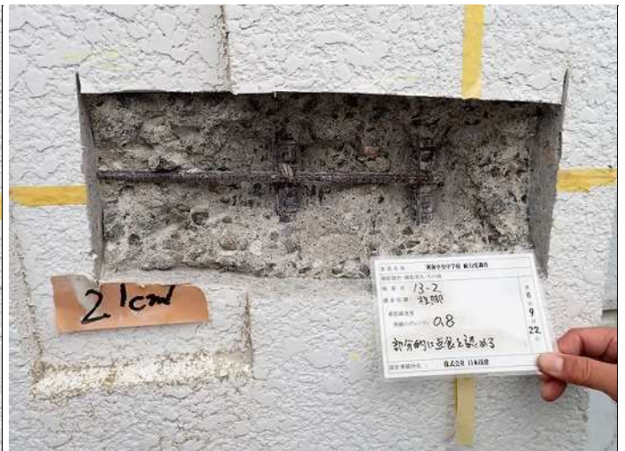
柱脚・柱2 鉄筋腐食度F 部分的に点食を認める(グレード0.8) 写真番号 18
