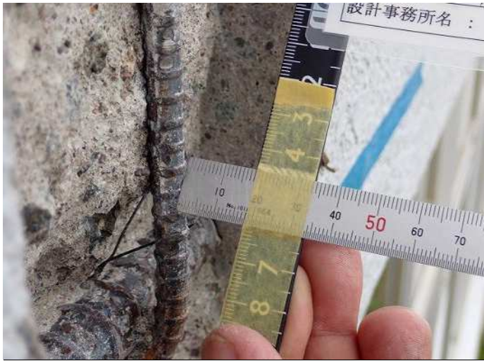
梁1 鉄筋かぶり厚さb 写真番号30詳細 写真番号 31
