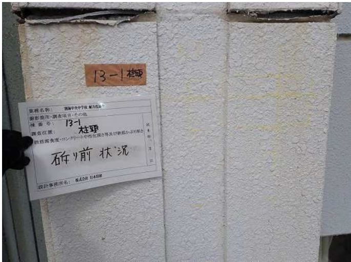
柱頭・柱1 はつり前状況 写真番号 3
