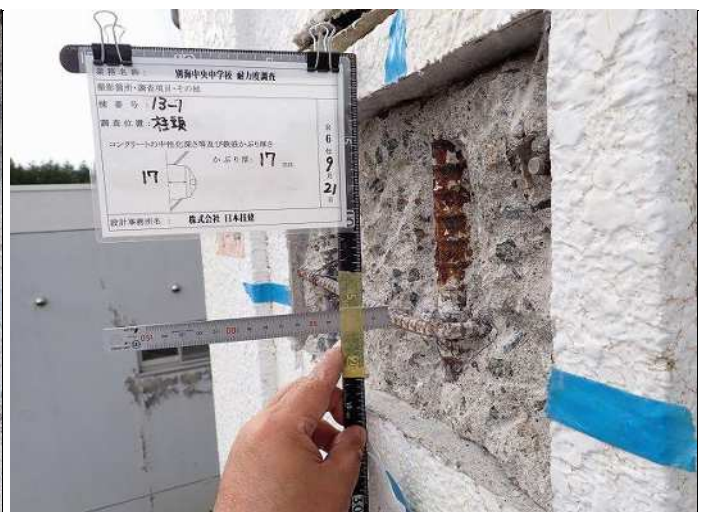
柱頭・柱1 鉄筋かぶり厚さb かぶり厚: 1.7cm 写真番号 8
