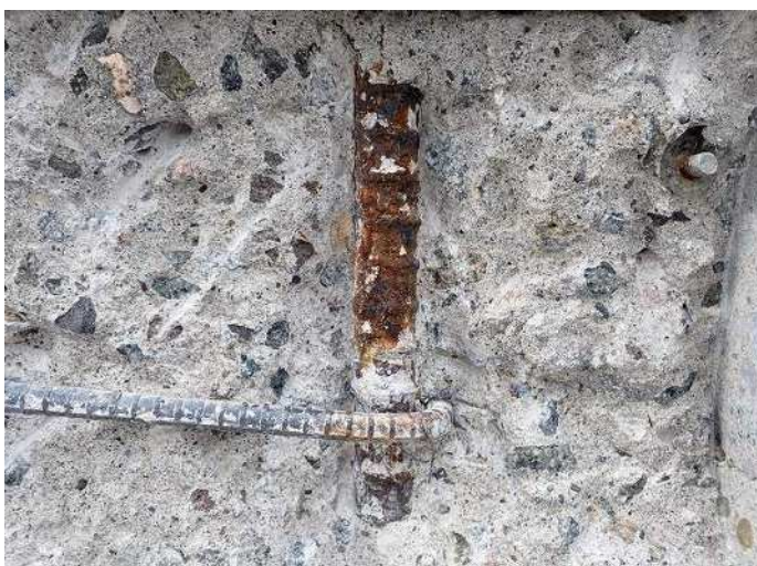
柱頭・柱1 鉄筋腐食度F 写真番号6詳細 写真番号 7
