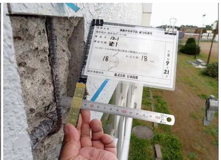
梁1 鉄筋かぶり厚さb かぶり厚: 1.8cm 写真番号 30
