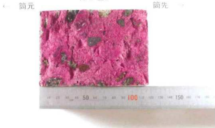
コンクリートの中性化深さ測定(フェノールフタレイン法) 別海中央中学校耐力度調査 別海中央中学校 13-1 壁2
