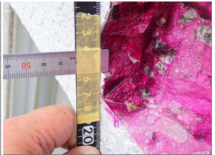
梁1 コンクリート中性化深さa 写真番号32詳細(2) 写真番号 34
