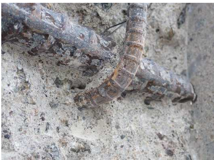
梁1 鉄筋腐食度F 写真番号28詳細 写真番号 29
