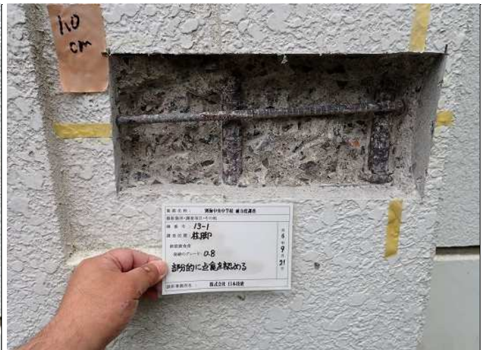
柱脚・柱2 鉄筋腐食度F 部分的に点食を認める(グレード0.8) 写真番号 17
