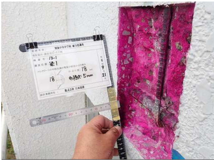
梁1 コンクリート中性化深さa 写真番号32詳細(1) 写真番号 33
