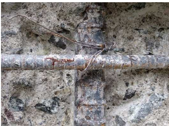
柱脚・柱2 鉄筋腐食度F 写真番号17詳細 写真番号 18
