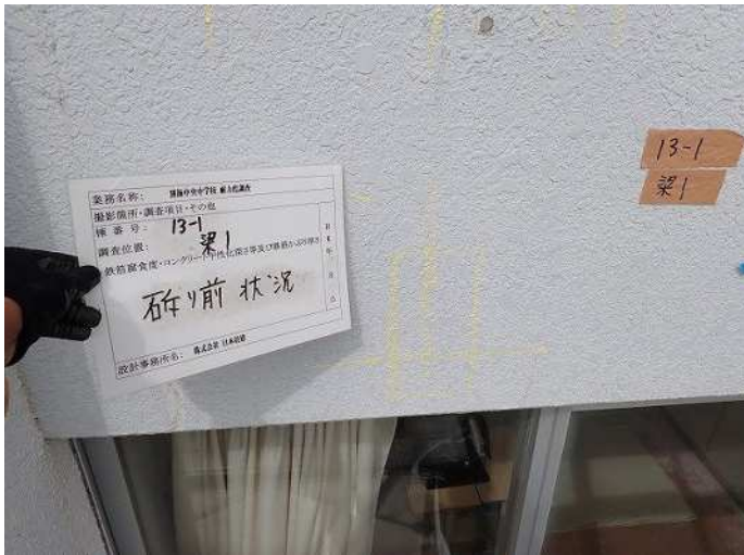
梁1 はつり前状況 写真番号 25
