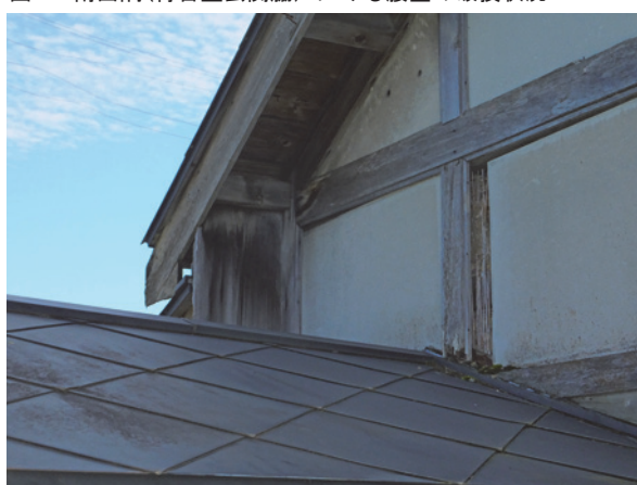
図 32 妻壁(北側)の破損状況
