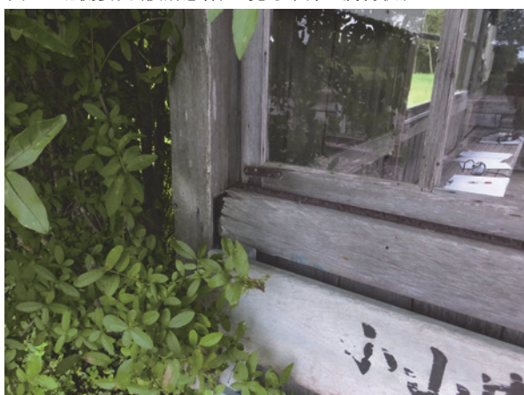
図 31 待合室窓枠の破損状況(ホーム側)
