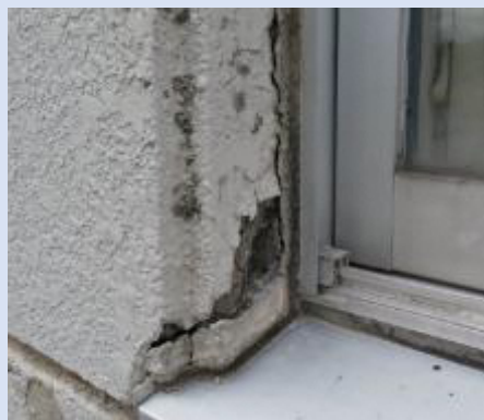
サッシ周辺部の劣化
