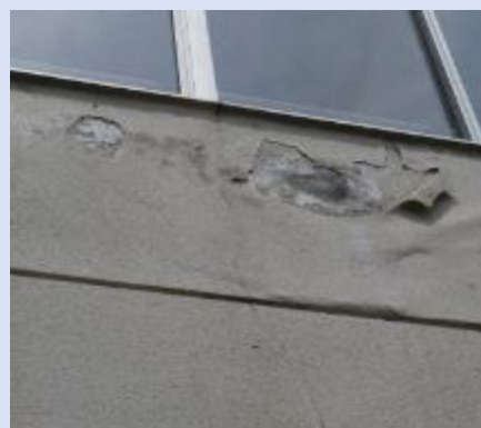
外壁塗装浮き(剥離)
