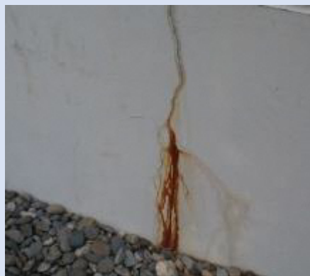
基礎モルタル亀裂(内部配筋錆び?)
