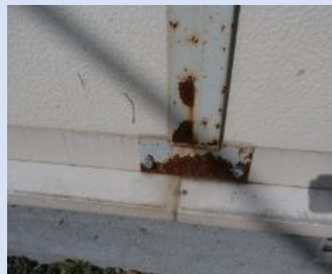
外壁鉄骨サビ(増築プレハブ棟)
