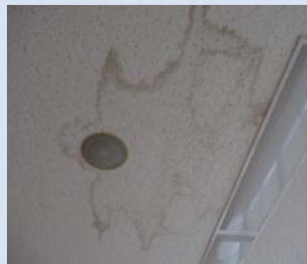
天井の雨漏り跡
