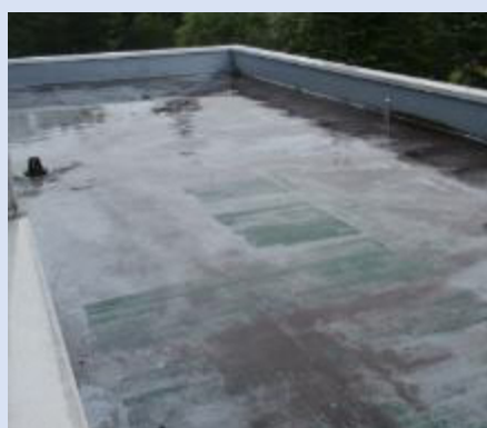
屋上防水(トップコート劣化)
