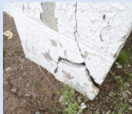
基礎モルタル亀裂・剥離
