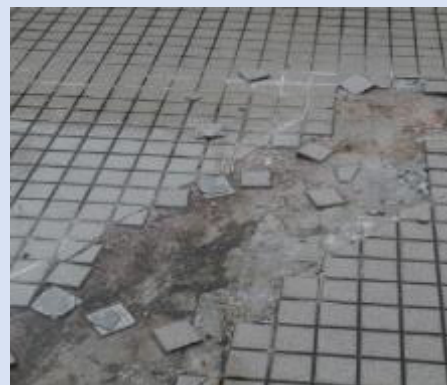
玄関ポーチ床タイル剥離
