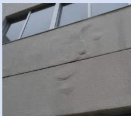
外壁(塗装浮き)
