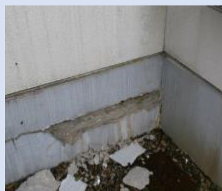
基礎モルタルの剥離
