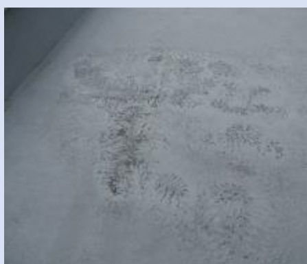
屋上防水(トップコート劣化)
