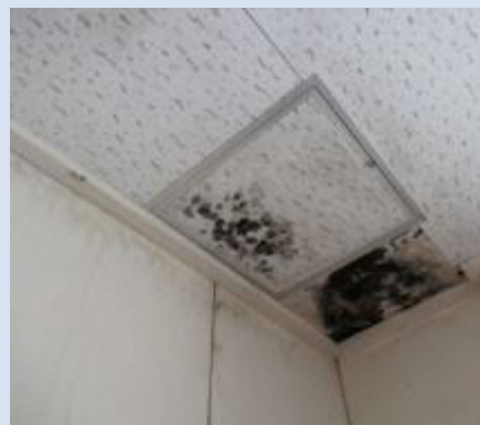
天井雨漏り部
