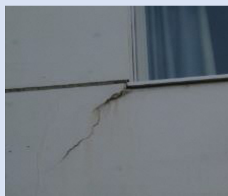
サッシ周囲の外壁亀裂
