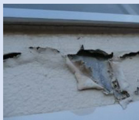
外壁塗装剥離
