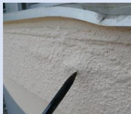
外壁塗装の浮き
