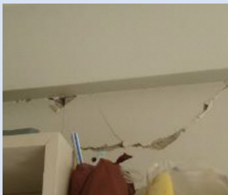
内壁ヒビ(1F教材室)
