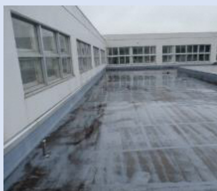
屋上防水(トップコート劣化)
