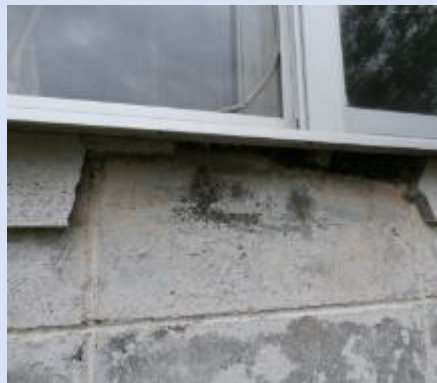
サッシ周辺部の劣化
