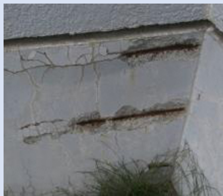
基礎配筋の錆び・膨張
