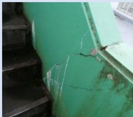
屋外階段破損
