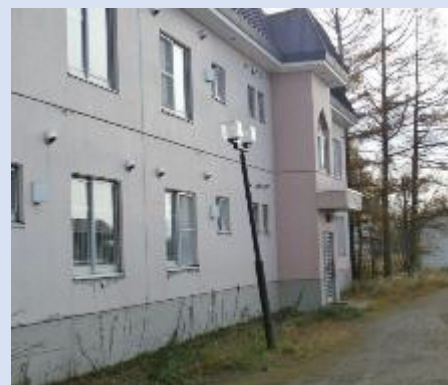
屋外照明柱の傾斜
