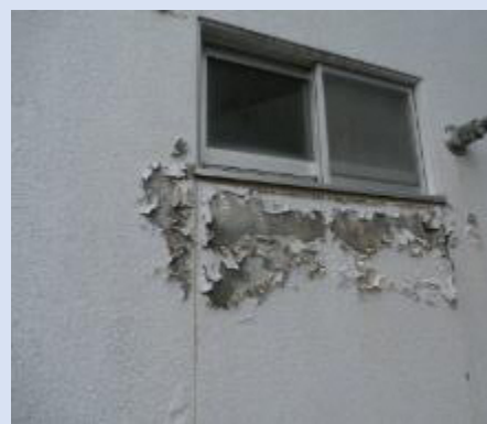
外壁塗装剥離
