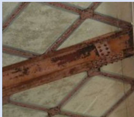
結露による鉄骨錆び
