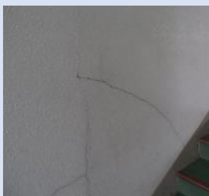
階段室内壁のひび割れ
