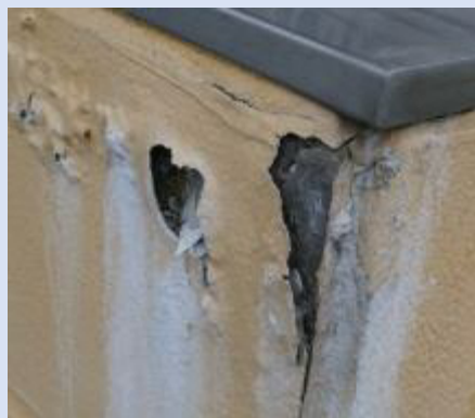
塗装劣化(剥離)
