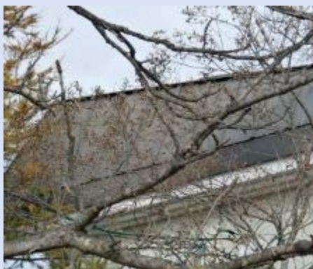
屋根塗装の劣化(変色)
