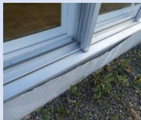
基礎モルタルの剥離(帯状一面)
