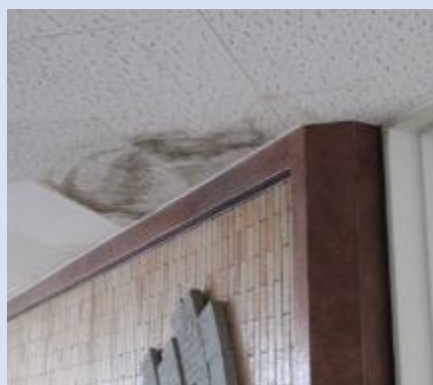
天井雨漏り跡
