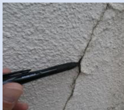
外壁塗装亀裂
