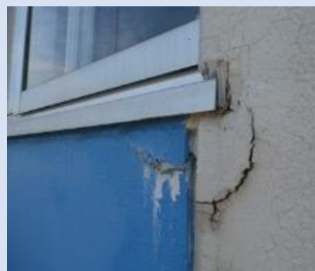
サッシ周り充填モルタル剥離
