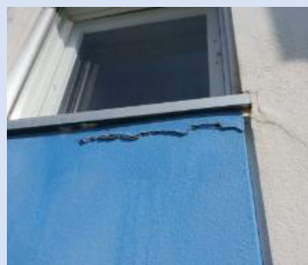
サッシ周り充填モルタル剥離
