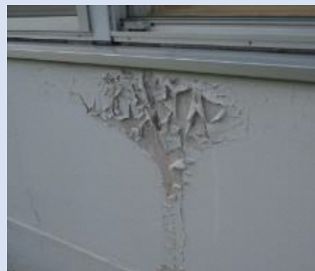
塗装劣化(剥離)
