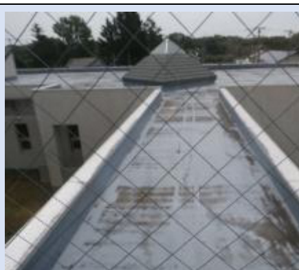
屋上防水(トップコート劣化)
