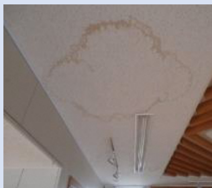
天井雨漏り部
