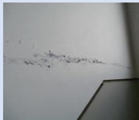
共用階段部の亀裂・塗装剥離
