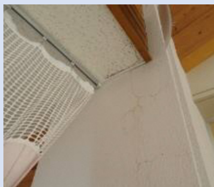
雨漏り箇所①
