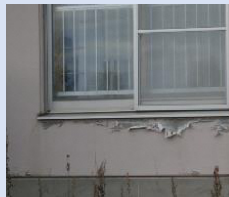
外壁塗装剥離
