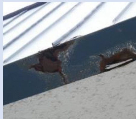
屋根板金の劣化(旧校舎棟)
