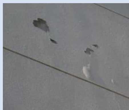
塗装劣化(剥離)
