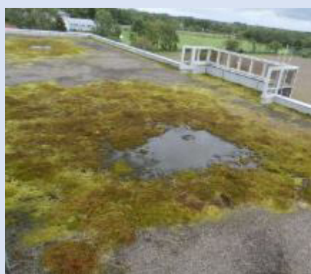
屋上防水(劣化)
