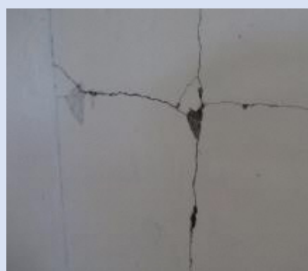
体育館内壁の亀裂
