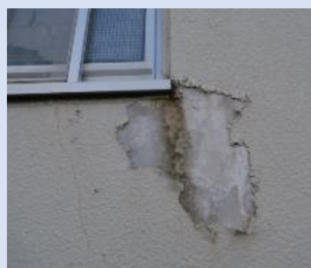
外壁塗装剥離
