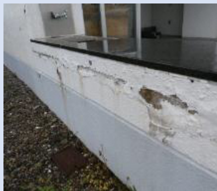
外壁塗装剥離
