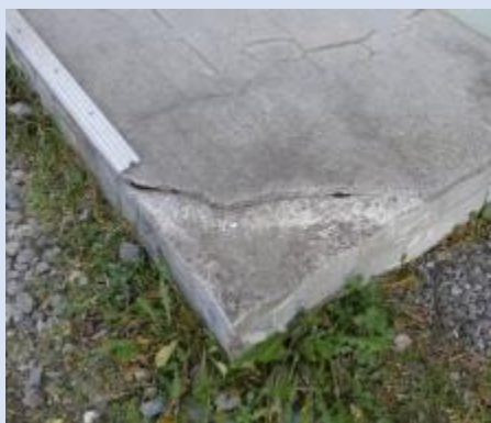
玄関ポーチ破損
