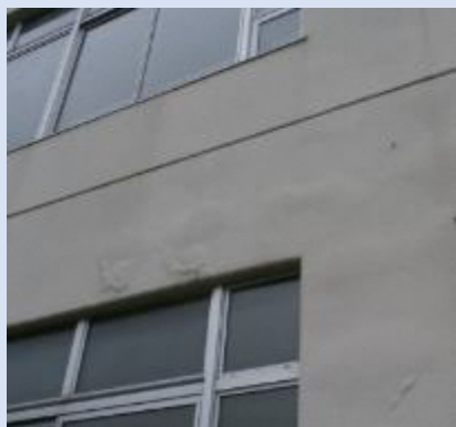
外壁(塗装浮き)
