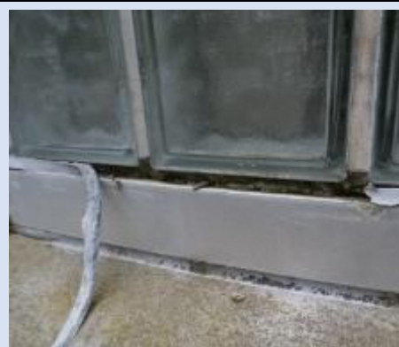
ガラスブロックシーラ剥離
