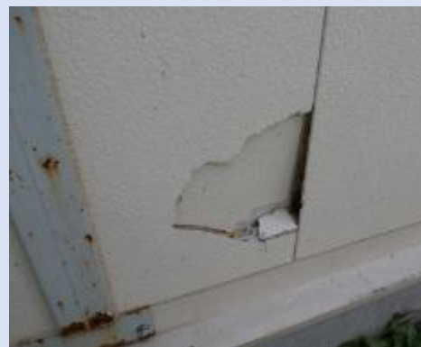
外壁破損(増築プレハブ棟)
