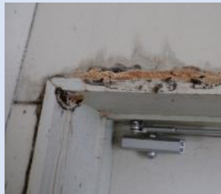
雨漏り跡(カビの繁殖)
