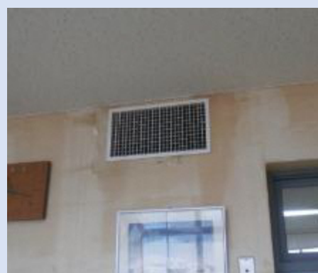
内装劣化・よごれ(校長室)
