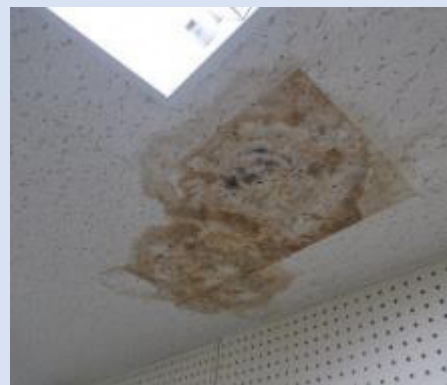
天井雨漏り跡(放送室)
