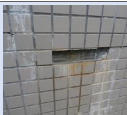
外装タイル部分亀裂・剥離
