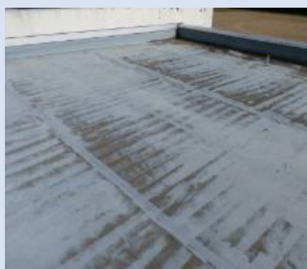
屋上防水(トップコート劣化)
