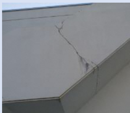
屋外階段破損
