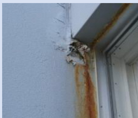
外壁塗装亀裂・剥離
