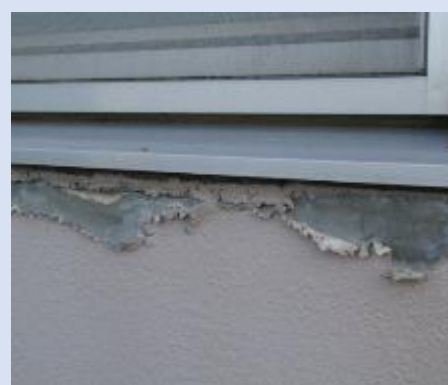
外壁塗装剥離
