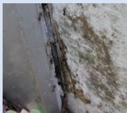
エクスパンジョイント部のシール劣化
