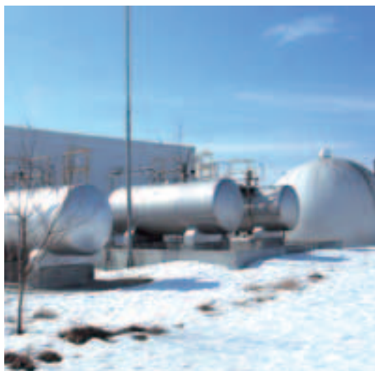
中西別のバイオガスプラント
