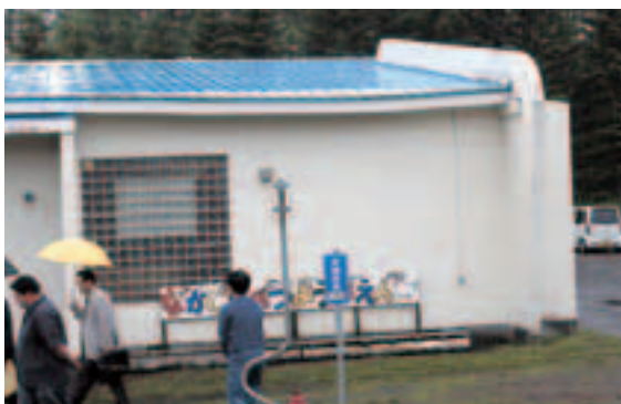
補正予算で老朽化が激しく屋根が歪んできている中西別幼稚園の改修が決まった
