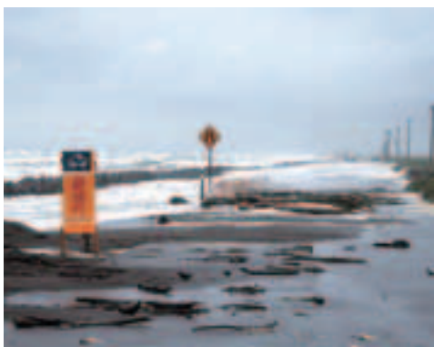
生命線である町道別海根室線が越波で寸断された
