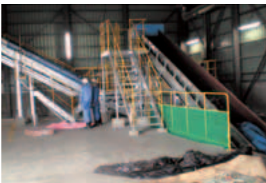
廃ラップ処理も始まった4町広域廃棄物処理施設
