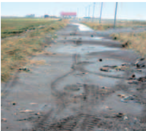
整備方針の確立が急がれる野付半島先端の道路
