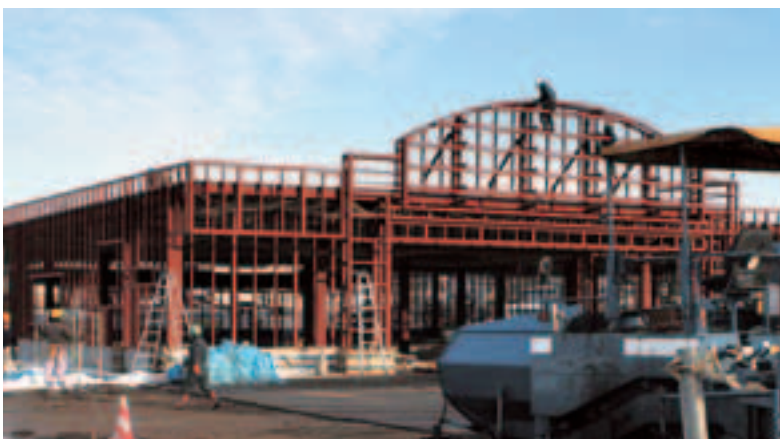
別海への出店が決まり建設が急ピッチに進むフクハラ
