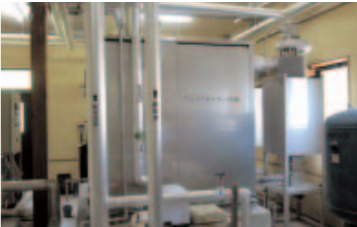
バイオマスエネルギー活用として注目されるペレットボイラー
