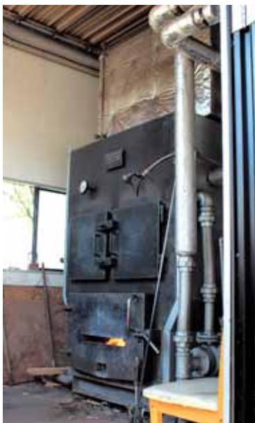
温泉水加熱のため導入したまきボイラー
