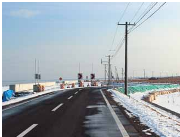
自然環境に配慮しながら進められる走古丹の道路改良工事
