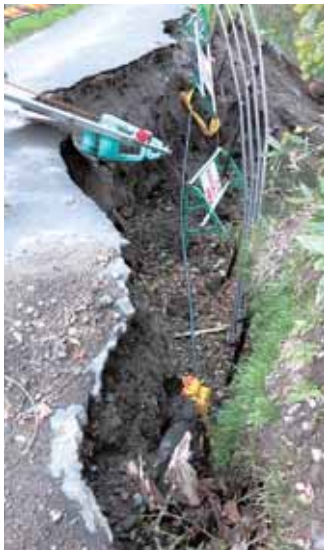
台風被害で大きく崩れた憩いの森に通じる小道
