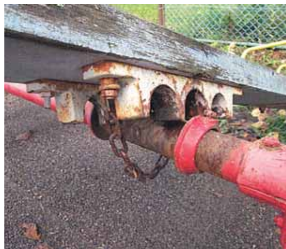
日ごろの点検や整備により事故を未然に防ぐことができる（現在は新しいものに取り替えられています）
