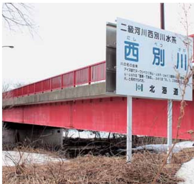
橋台クラック補修が予定されている旭橋
