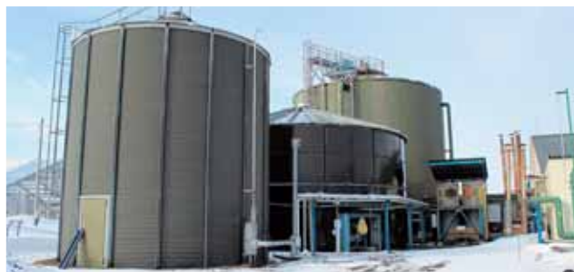
町内で稼働中のバイオガス発電施設（別海バイオ株）
