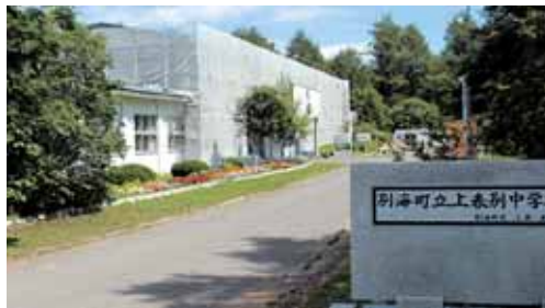
経年劣化により全面的に改修される上春別中学校
