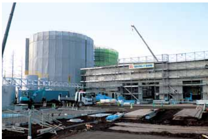
今年2月の完成をめざし着々と工事が進むバイオガス発電施設
