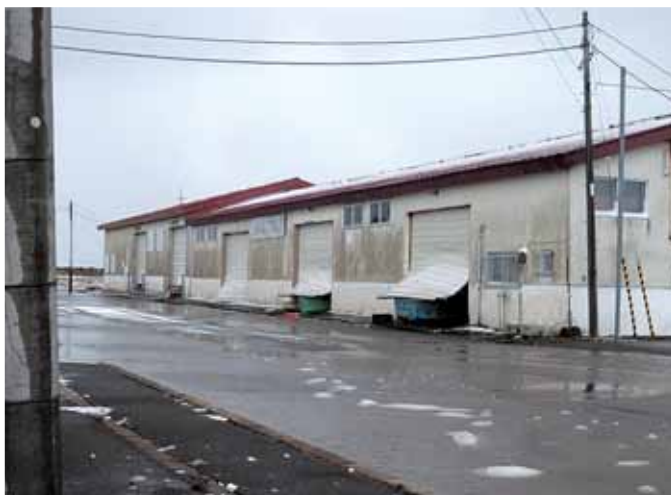
昨年12月の低気圧により高潮被害を受けた別海漁協施設
