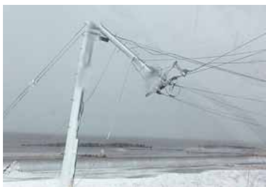
暴風雪により折れた電柱
