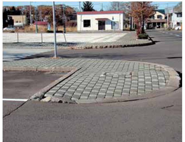
車椅子やシニアカーを利用する人にとって、歩道の傾きや段差は深刻な問題だ 利用者の立場に立ったインフラの整備が課題とされている
