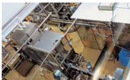
老朽化が進む製造ラインの機器
