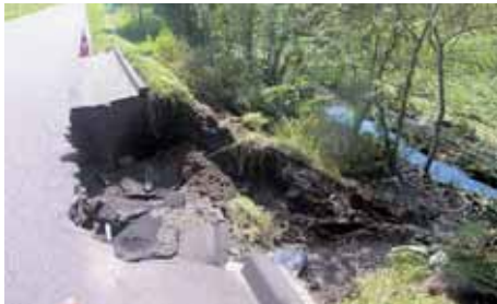
豪雨により決壊した道路
