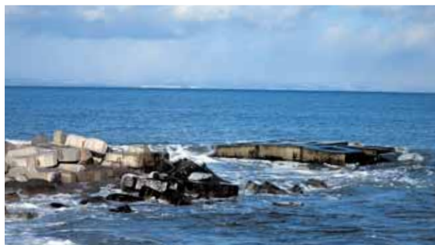
度重なる暴風雨により崩れた突堤（野付半島）
