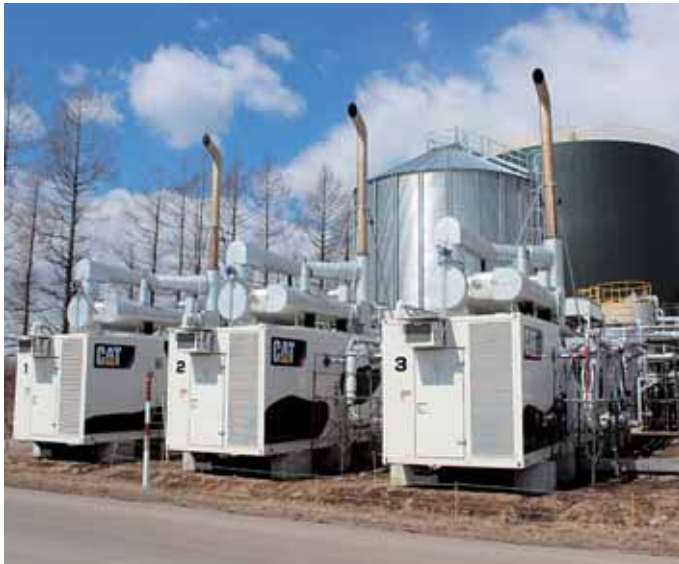
別海バイオガス発電機(株)で使用されている600kw級発電機3基
