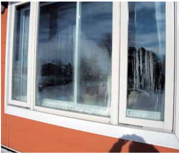
ひどい結露が問題となっている防音住宅
