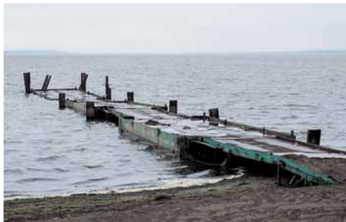
桟橋としての機能を失い沈んでいる風蓮湖の浮桟橋
