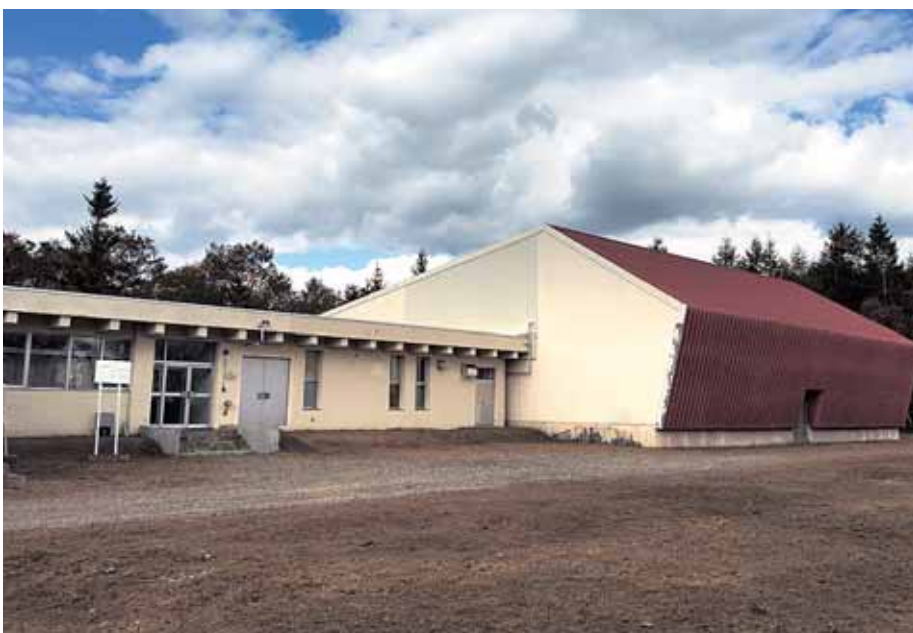
老朽化が進み更新が必要な当町の浄水場
