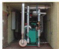
機械室内部（コンテナ使用例）
