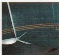
発酵槽内部（攪拌羽と温水配管）
